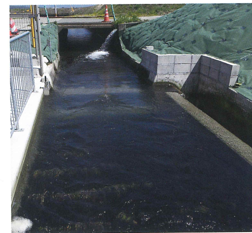
取水口。必要な量の水を確保し、ゴミや落ち葉が流入しないようにスクリーンが設置されている。
