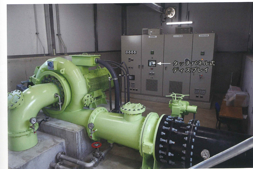
横軸単輪単流 フランス水車と横軸三相誘導発電機、変圧器。変圧器に備え付けているタッチパネル式のディスプレイに発電の状況が反映され、スマホ等へデータが送られてくる。異常があった際にはすぐにわかるようになっている。
